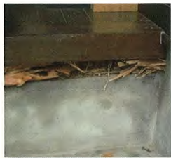
〈勝手口框被害例〉
