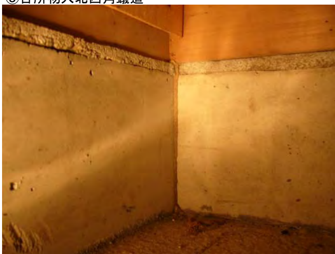
③台所物入北西角蟻道
