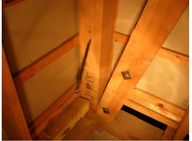
⑤階段北西角柱被害
