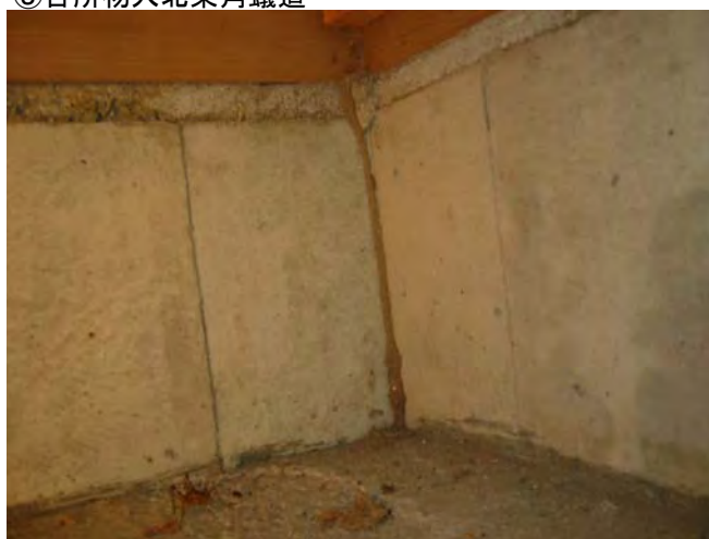
③台所物入北東角蟻道
