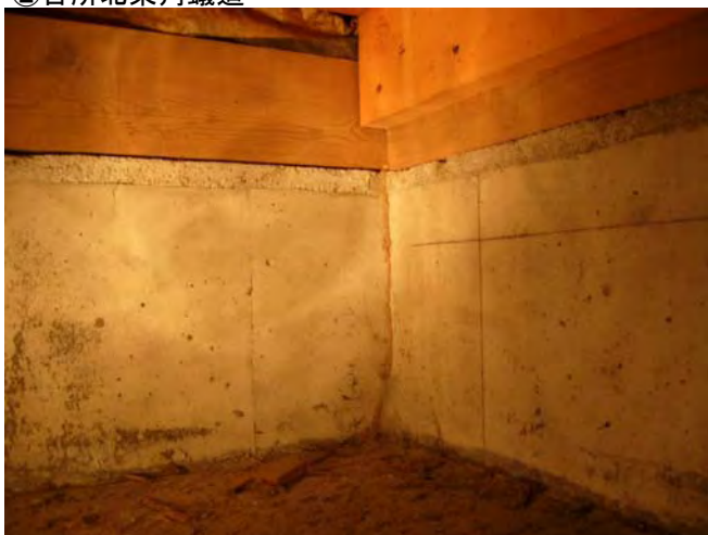
②台所北東角蟻道
