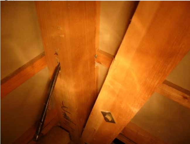
⑤階段北西角柱被害
